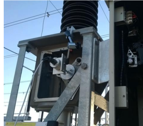
Transductor rotativo digital montado en un interruptor de SF6 de 245 kV de ABB LTB
